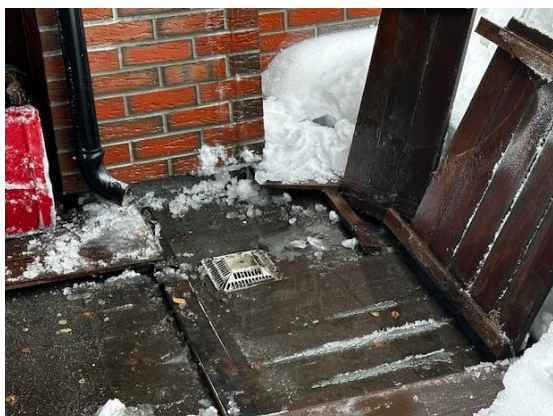
Bilde 5 over: Sluk under terrassebord på terrassen (jupiterveien 96)
